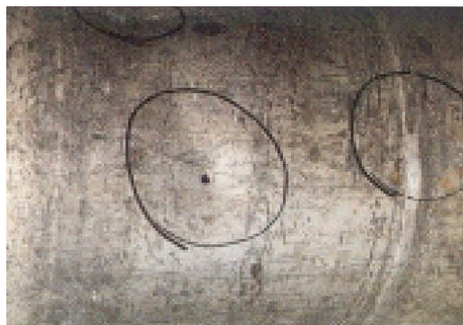
fig. 4 : cylindre avec des creux dans la soudure et sur la paroi
